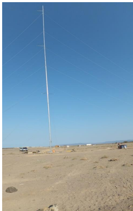
Station de mesure éolienne d'une hauteur de 60 mètres au Goubhet. Vitesse moyenne annuelle de 12 m/s
