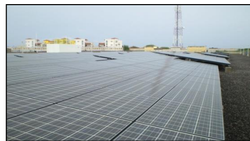
Panneaux solaires Photovoltaïques de la centrale
